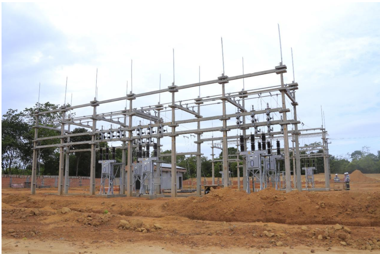
SUBESTAÇÕES DE ENERGIA ELÉTRICA – SANTANA - 2022
