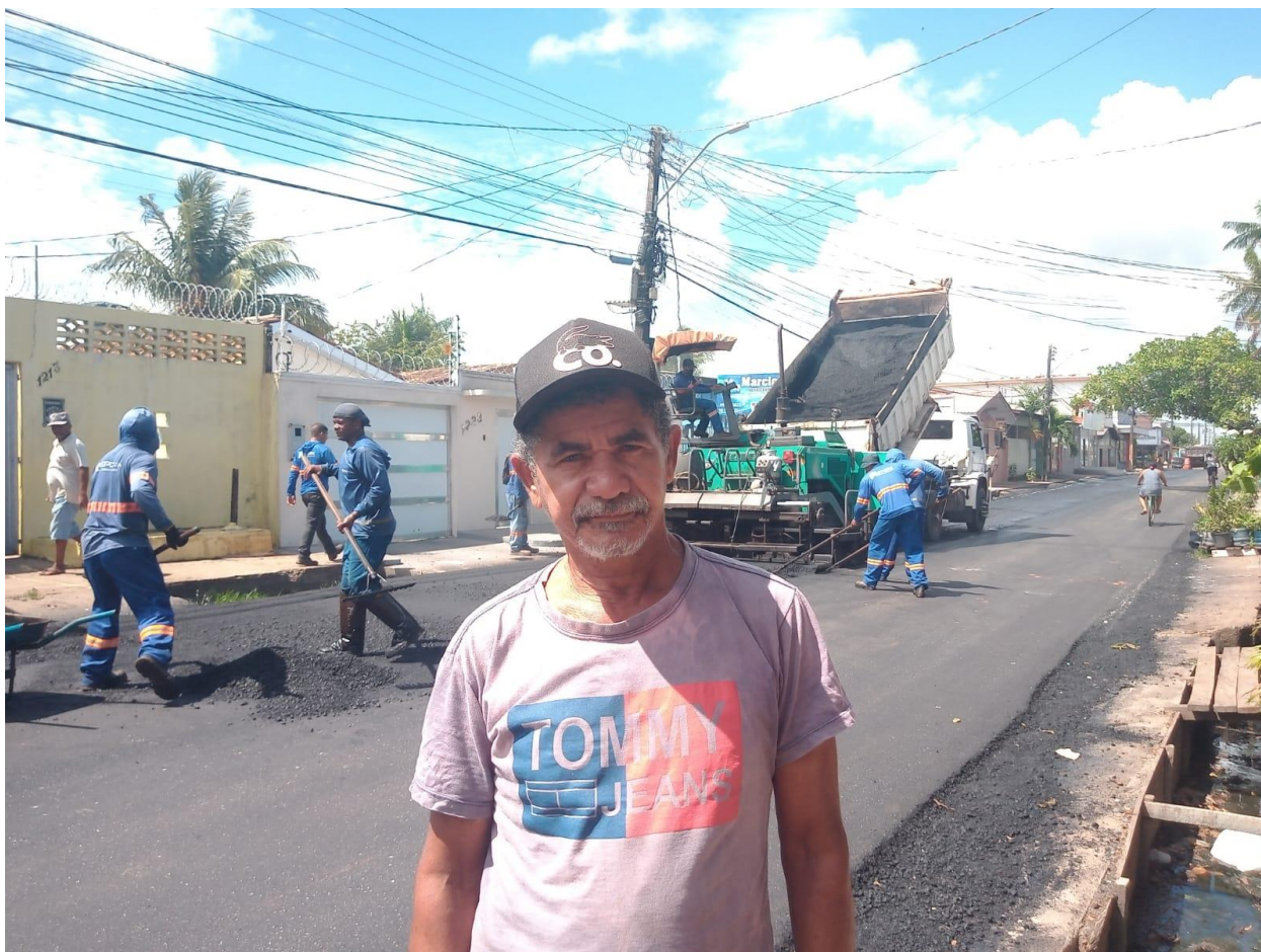
PAVIMENTAÇÃO DE VIAS URBANAS EM MACAPÁ – PLANO ESTADUAL DE MOBILIDADE URBANA – 2021.
