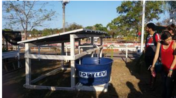
Foto 13 - Sistema de bombeamento de água com energia solar fotovoltaica.
